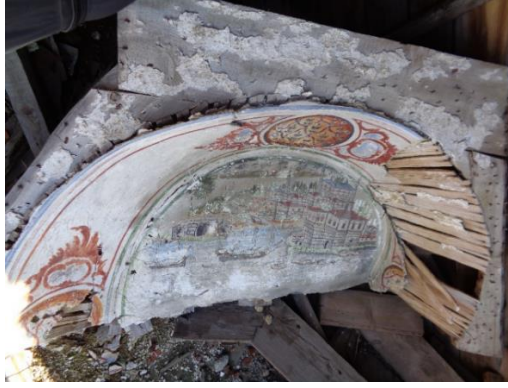
Resim 18 Köşk mekânında yer alan düşmüş vaziyette manzara resmi
